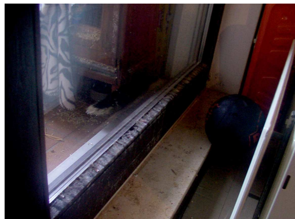
Schimmelbefall am Rahmen des Wohnzimmerfensters
