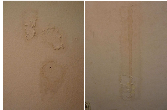
Spuren des Rohrbruchs im Wohnungsflur
