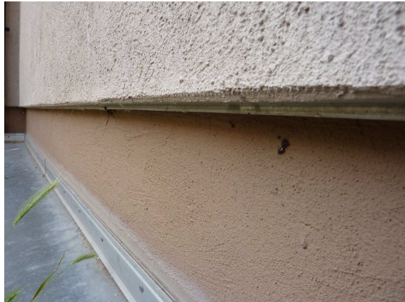
Mutmaßliche Ursache des Schimmelbefalls ist die Unterkante an der Dämmung
